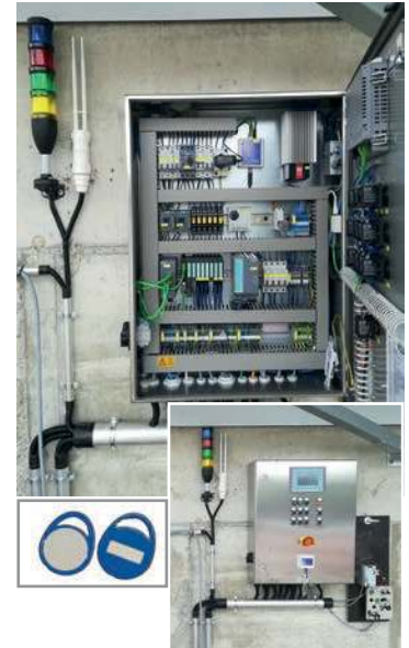
Schaltschrank Fassfüllen mit Panel, Vorort-Tableau und RFID-Empfänger
